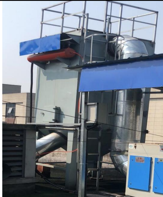
布袋除尘+两级活性炭设施装置照片图
